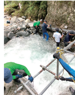
額平川の難関徒渉箇所には仮橋を設置している様子。四の沢出合付近
